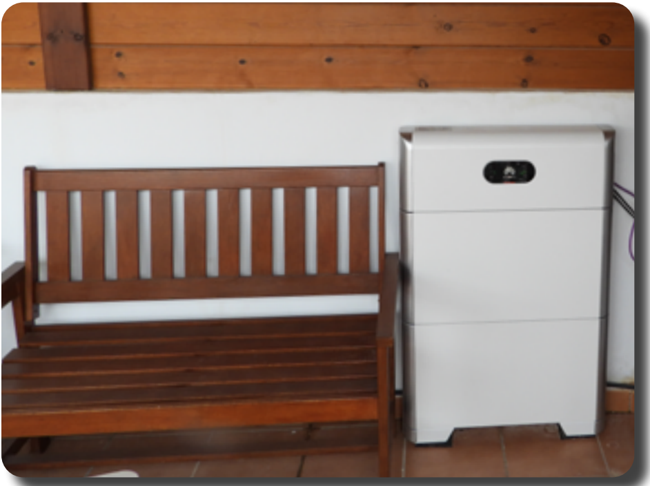
Batería Huawei con dos módulos, instalada en Rojales (Alicante).
