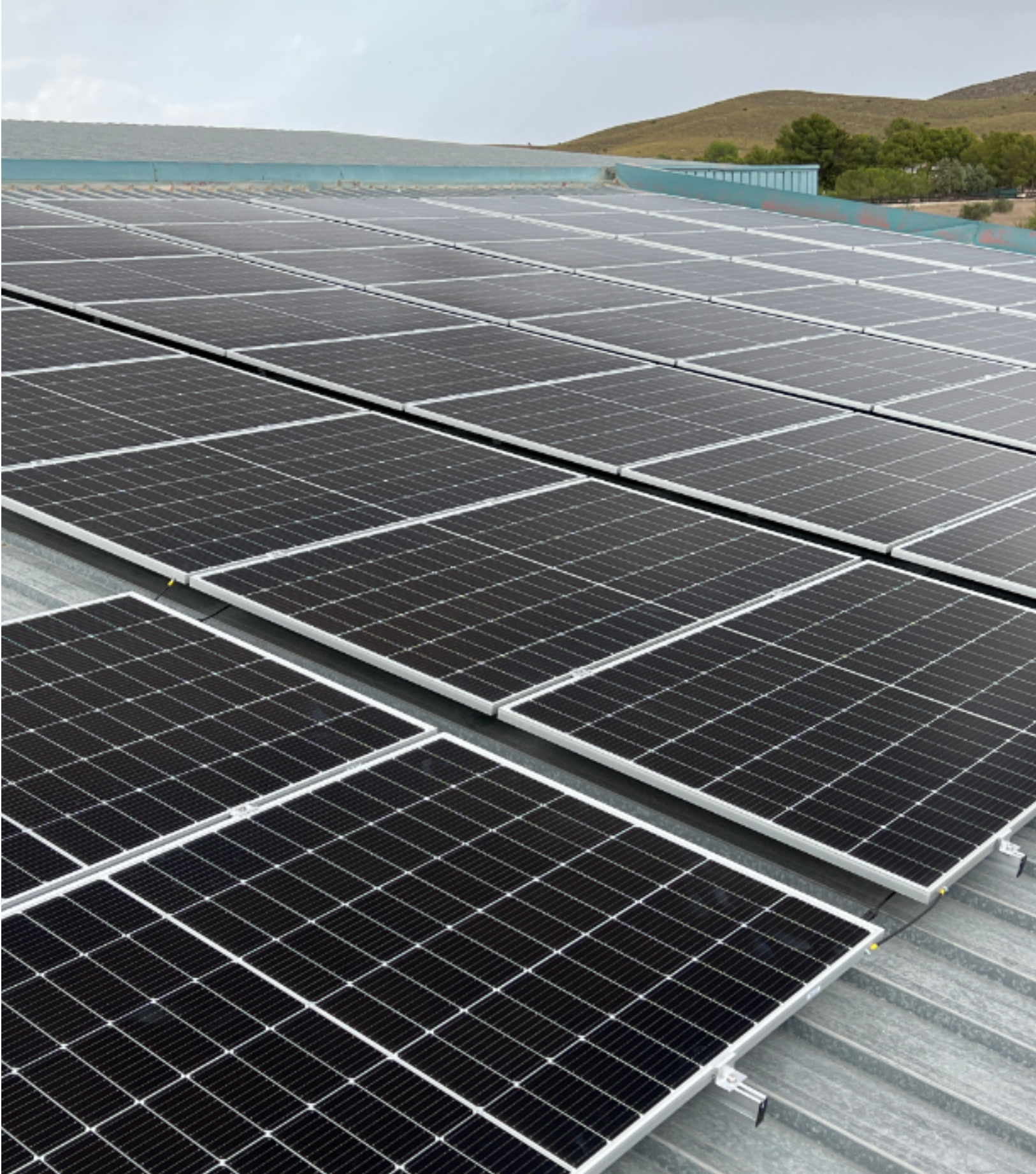
Instalación fotovoltaica realizada en Yecla (Murcia)
