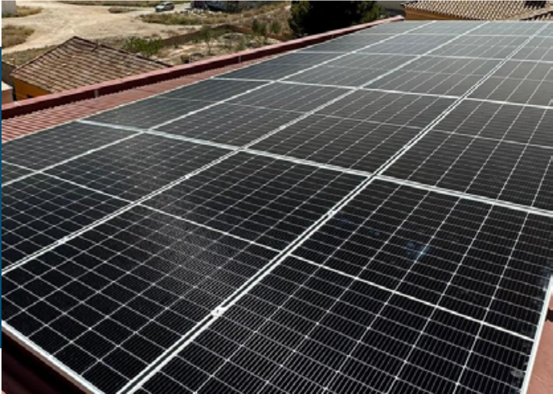
Instalación fotovoltaica ubicada en Sangonera la Seca (Murcia)
