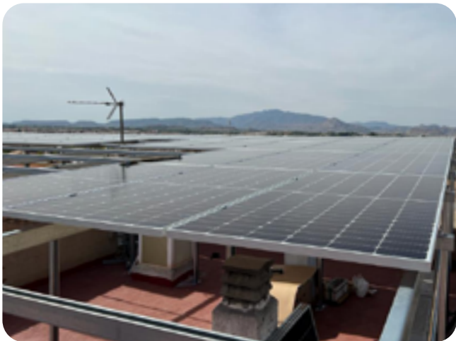
Instalación fotovoltaica compartida en Lorquí, Murcia
