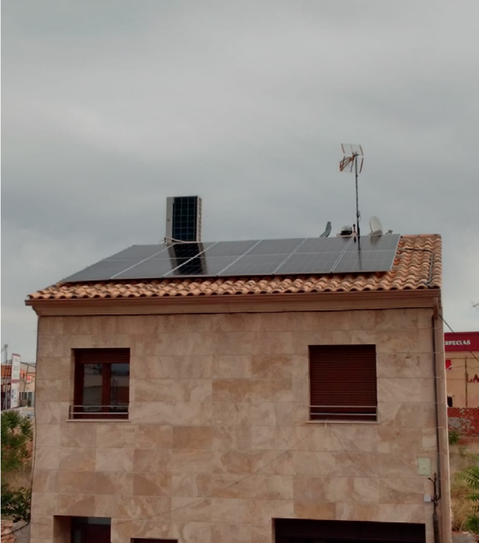
Instalación fotovoltaica realizada en Manzanares (Ciudad Real)
